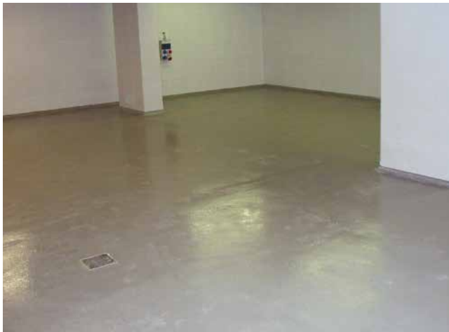
Laque époxy SoproDur® HF-L 513 sur le sol d'un local de stockage d'ordures, en association avec des murs carrelés.
