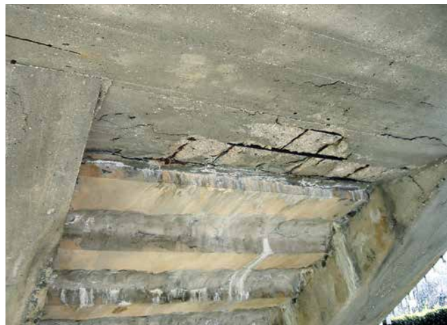
Dégradations par la corrosion en sous-face d'escaliers, dues à l'absence d'étanchéité et à une épaisseur de béton insuffisante.
