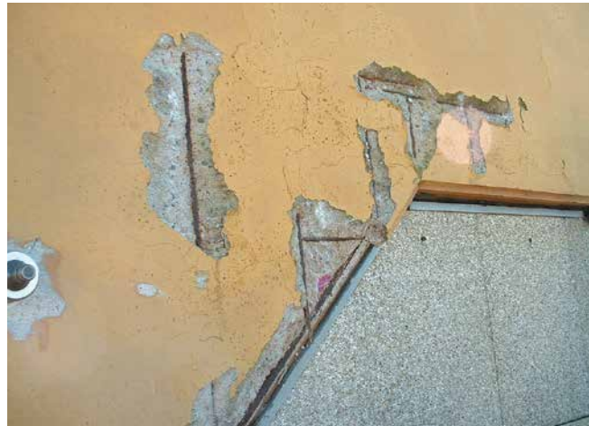
Eclats sur une façade, dus à une épaisseur trop faible de béton
